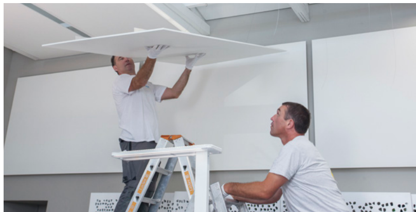
Die Absorber können bequem von einer Person bewegt und gehalten werden. Der zweite Kollege unterstützt die Positionierung und das Einhängen der Seile. Foto: Knauf/Bernd Ducke
