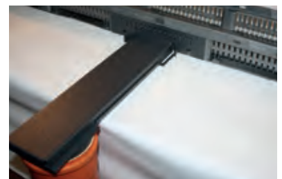
KG-Rohr DN 100 kann angeschlossen werden
