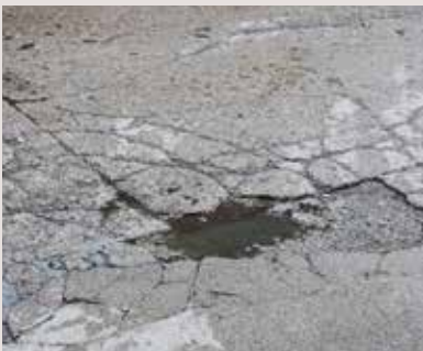
▲ Problem rissiger Fußboden
