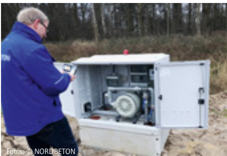
Steuerschrank mit digitaler Betriebsführung.
